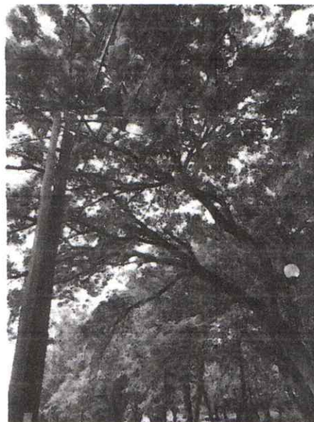
Foto 2. Vista lateral del árbol de Samán donde se aprecia la distancia de la copa que recubre el cableado eléctrico y el alumbrado público.
